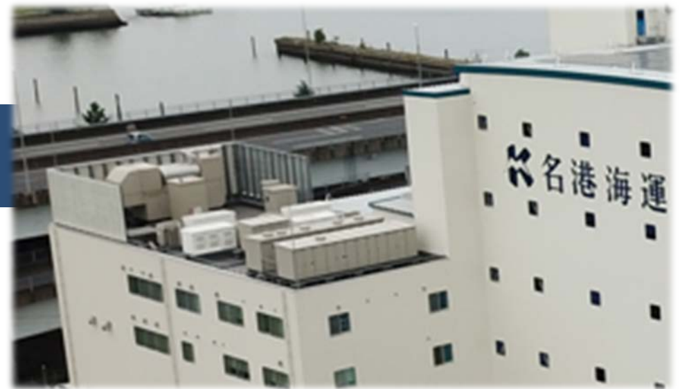
西二区物流センター（南）に設置された非常用発電装置
